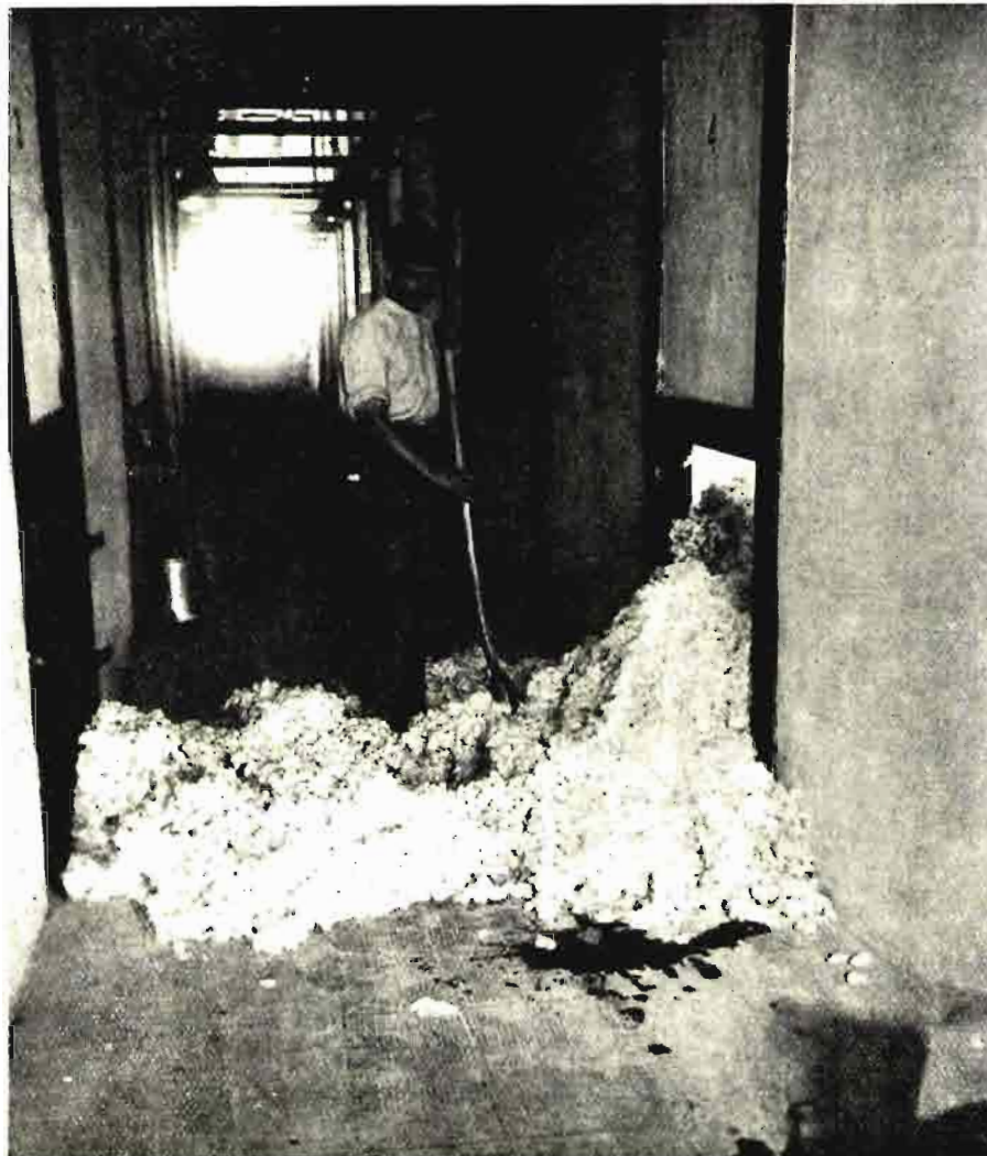
Sistema subterráneo de alimentación de algodón bruto a las desmotadoras, aplicado por primera vez en la Factoría de Tabladilla (1925).
