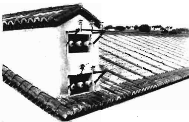
Salida de las líneas de alta.
