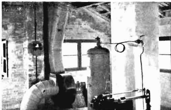
Caseta de maniobras, con el extractor de gases y botella de bromuro.
