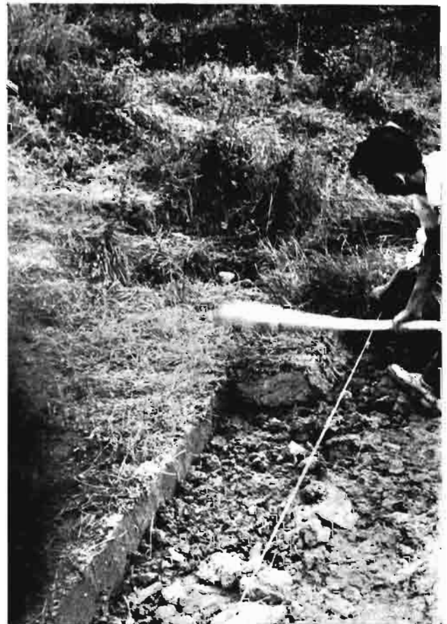
La misma arcilla del terreno se utiliza en la construcción de los diques.
