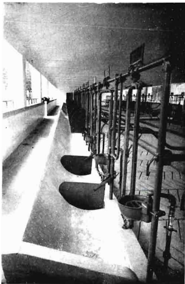
Instalaciones Jamesway en los pabellones G y H.
