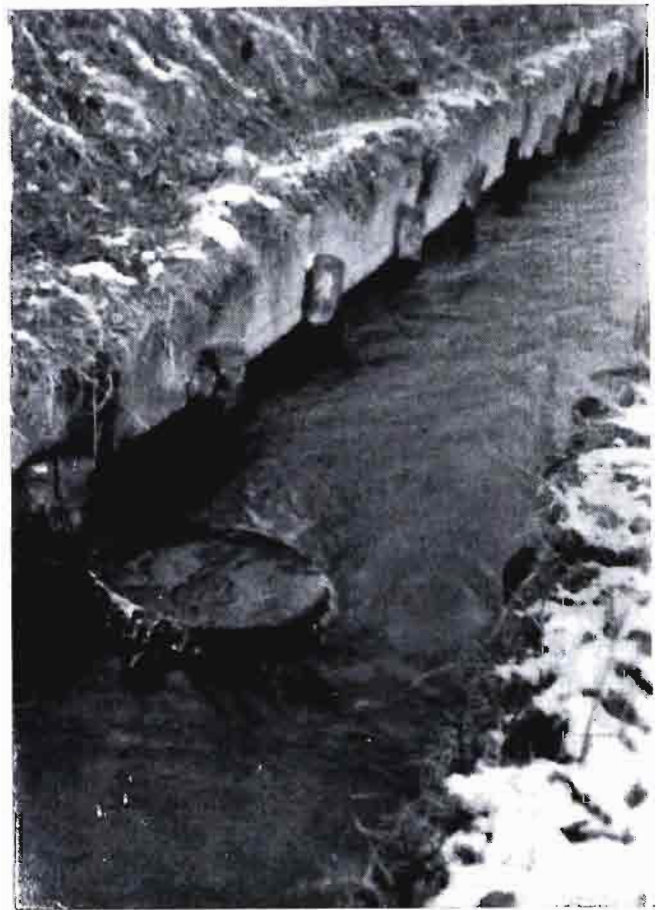
Fig. 2.ª.- Los tubos se cierran cuando no es necesario su caudal
