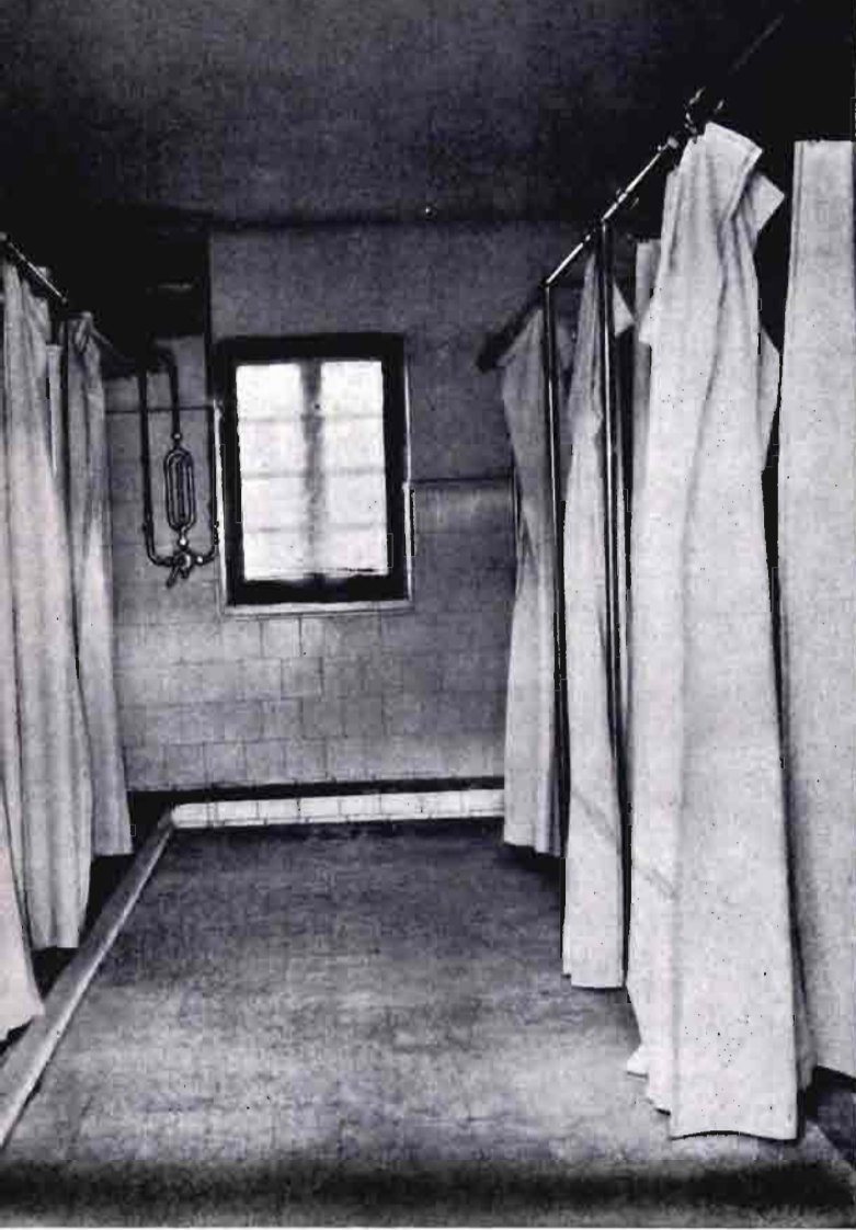
Duchas para el personal de establos. (Foto "Ventosilla".)
