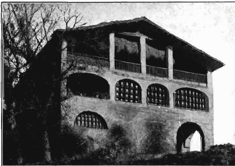
Como la fachada de esta casa de labranza hay muchas viviendas rurales, sucias y corroidas por la humedad que desde el suelo asciende por los muros, motivando daño a la construcción y a las personas que la habiten.
