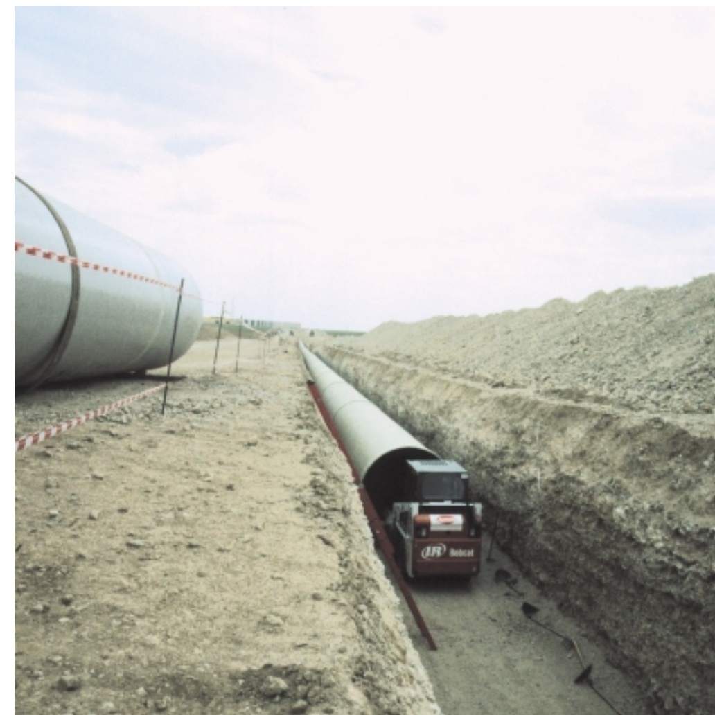
■ Obras de la primera fase del nuevo abastecimiento a Zaragoza y su entorno.
