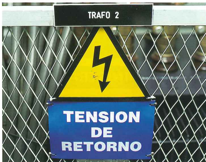
■ El 35 por ciento de los aparatos con PCB fueron adquiridos por el sector eléctrico.
