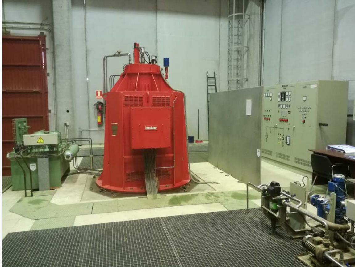
Generador y cuadro de mandos en la Central hidroeléctrica Montanera
