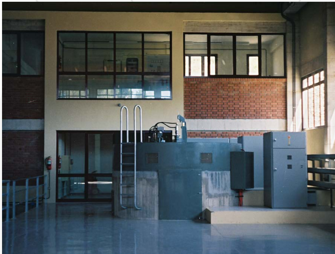
Interior de la Central Hidroeléctrica Sotónera
