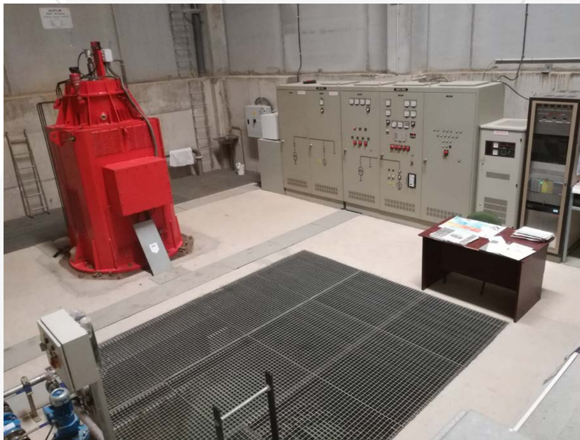
Generador y cuadro de mando de la Central Hidroeléctrica Torrollón
