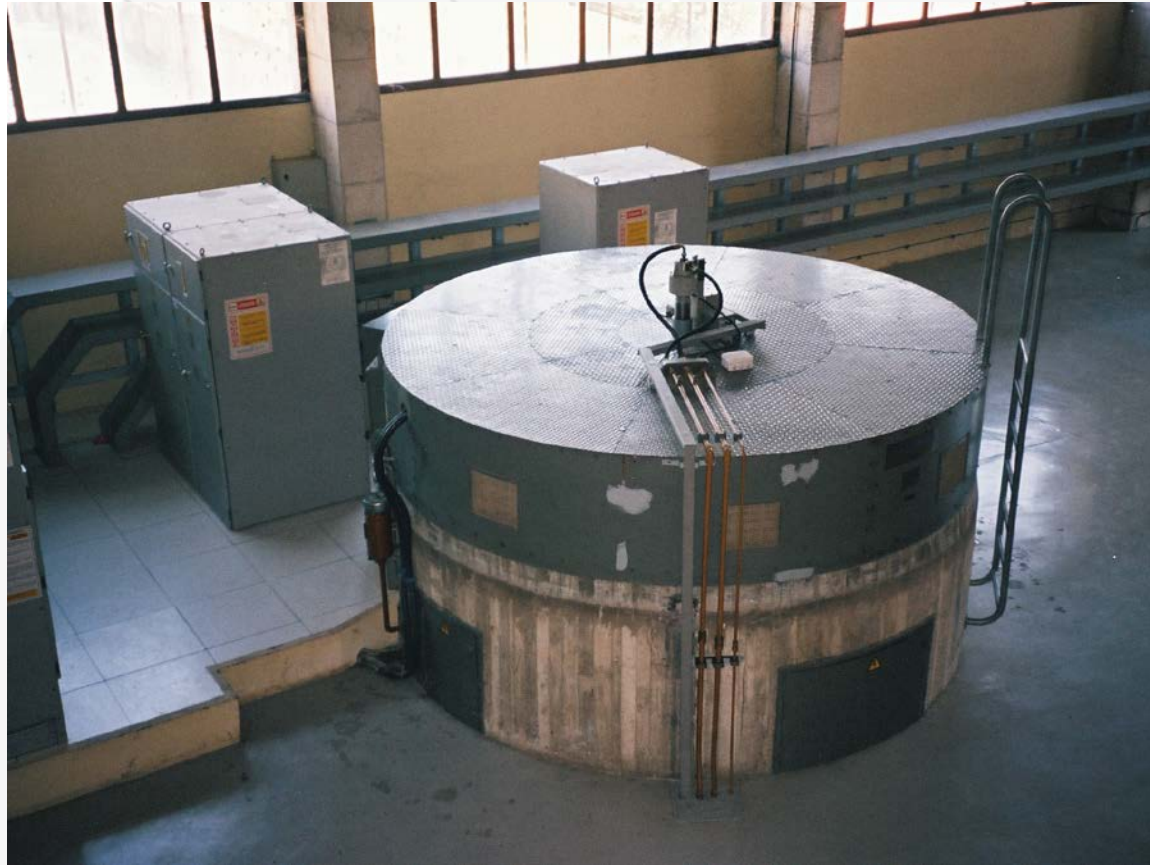
Generador en la Central Hidroeléctrica Sotonera
