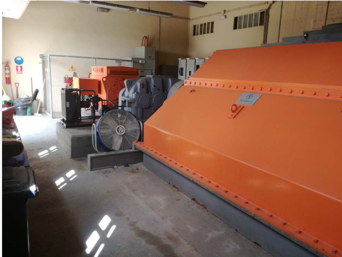
Generador y turbina en la Central Hidroeléctrica Odina
