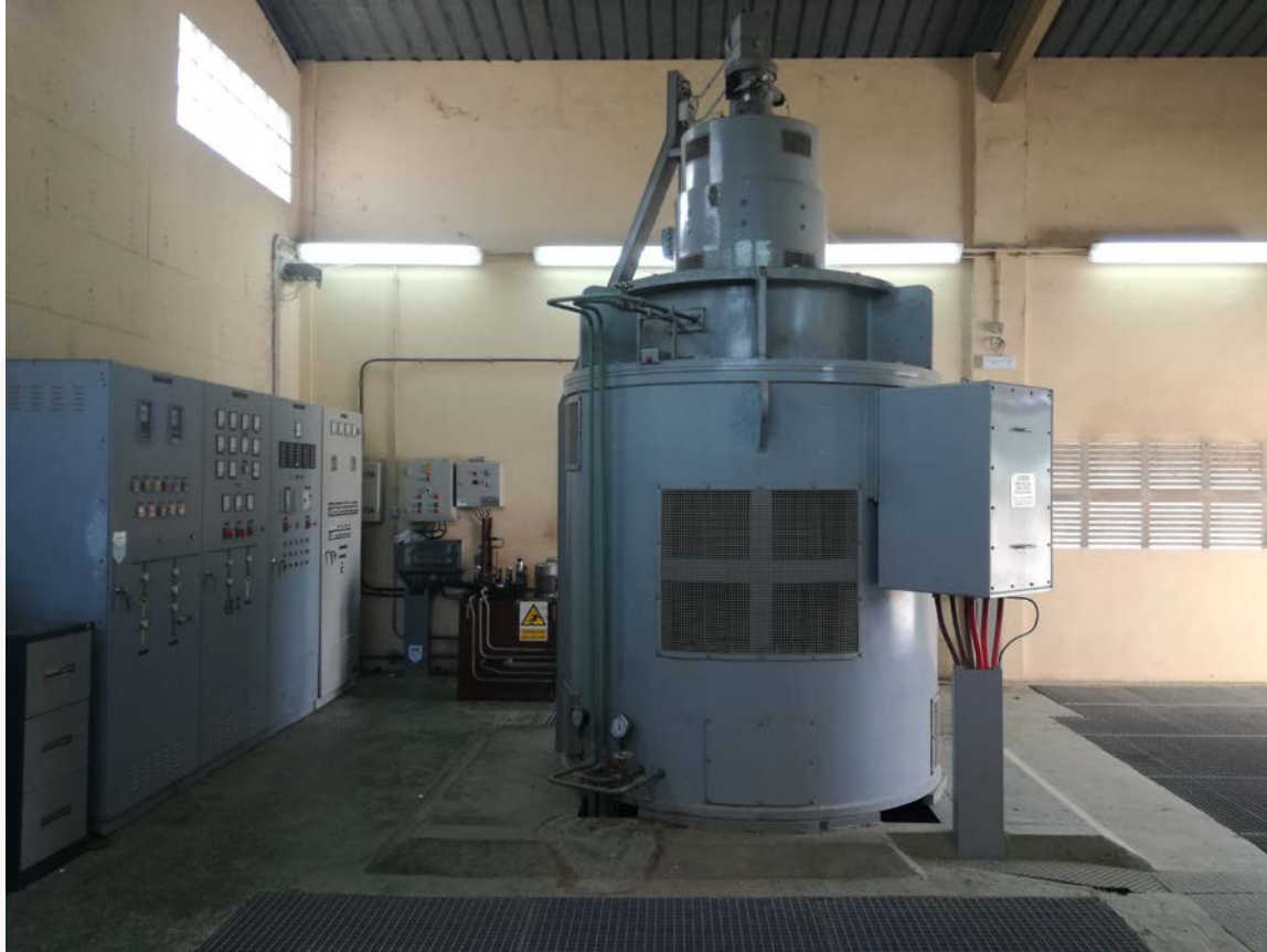
Generador y cuadro de mandos en la Central Hidroeléctrica Berbegal
