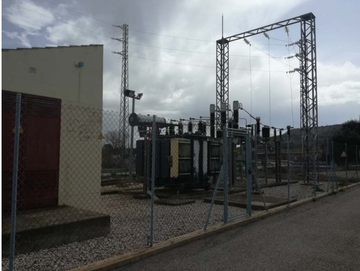
Subestación de la Central Hidroeléctrica Berbegal
