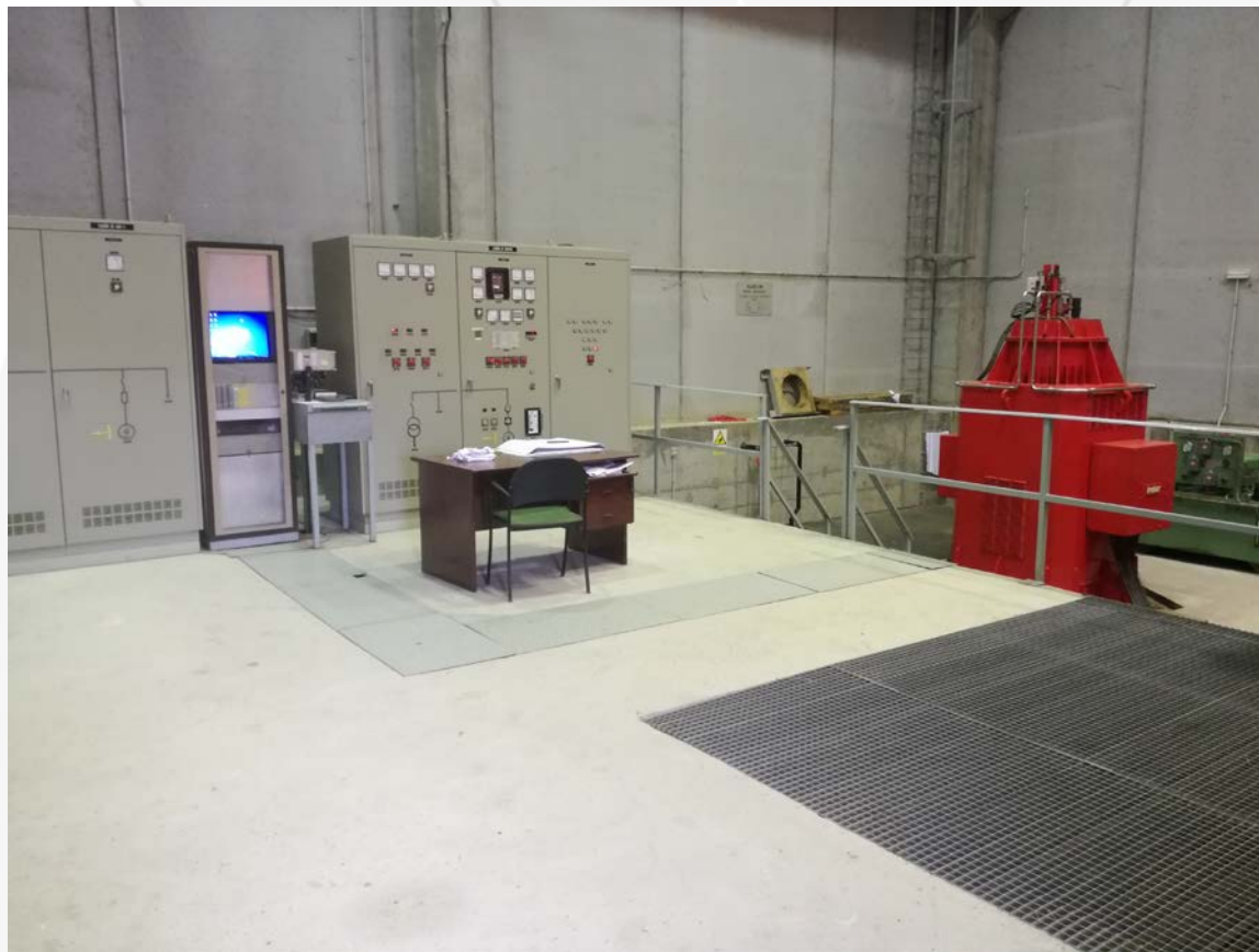
Generador y cuadro de mando en la Central Hidroeléctrica Piraces
