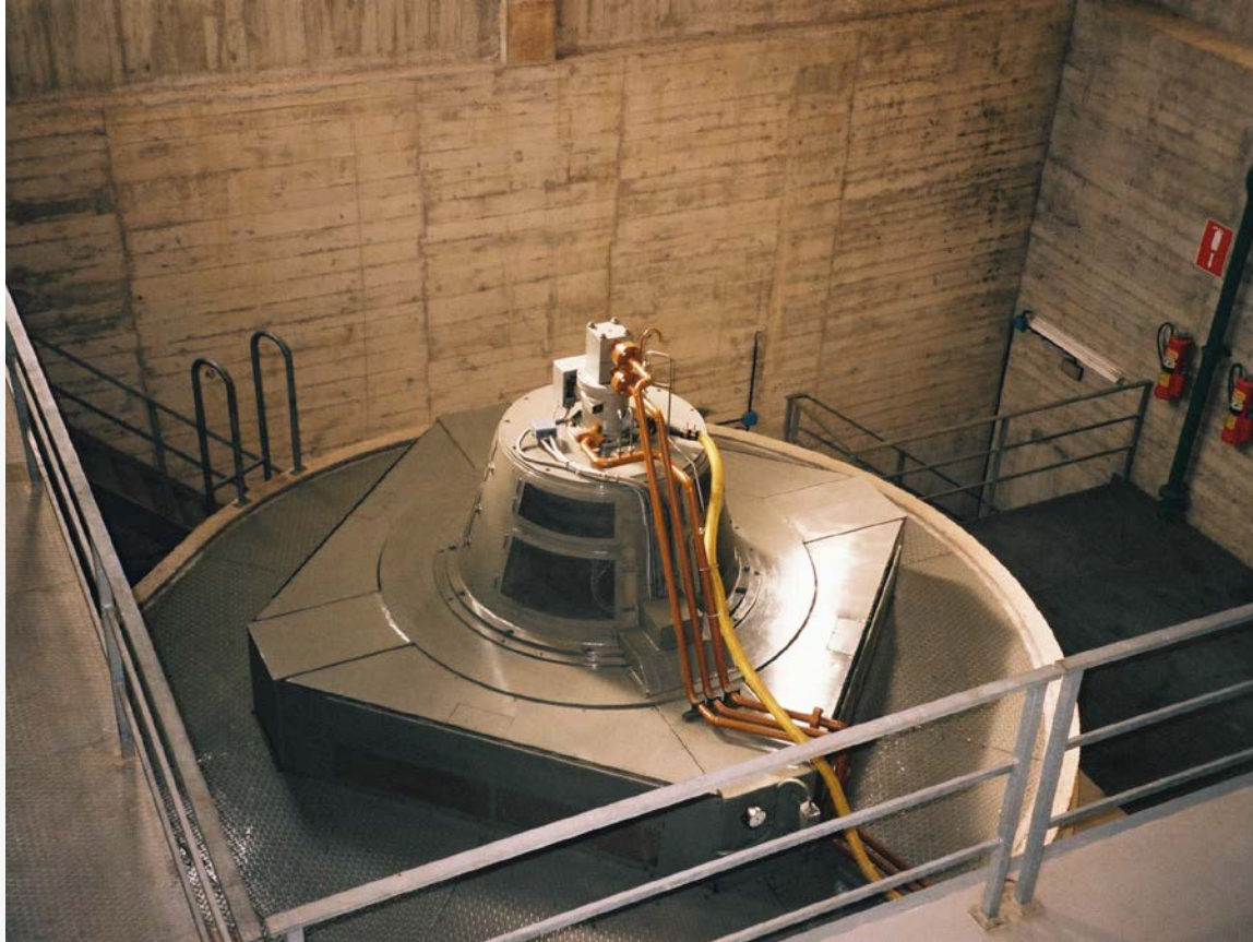
Alternador en la Central Hidroeléctrica Valdespartera
