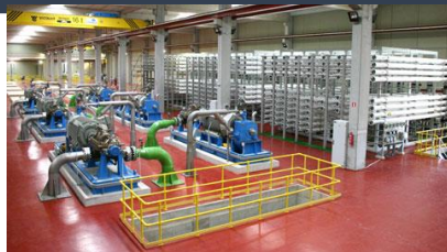
Desaladora de Valdelentisco
