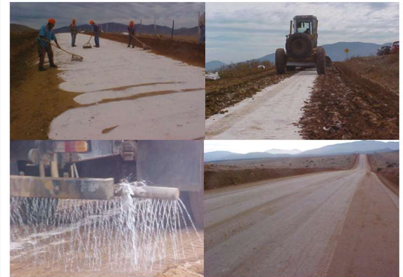
Fotos N° 1 a N° 4. Esparcido de sal, homogeneización, adición de agua de compactación y resultado final de una carpeta con cloruro de sodio
