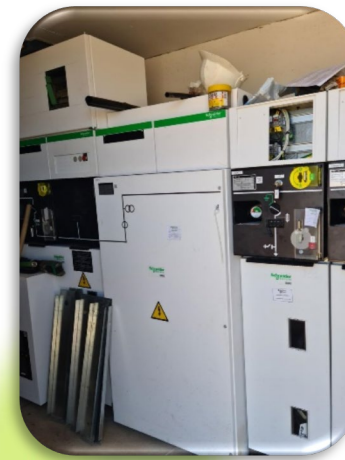
Cuadros, transformadores y celdas
