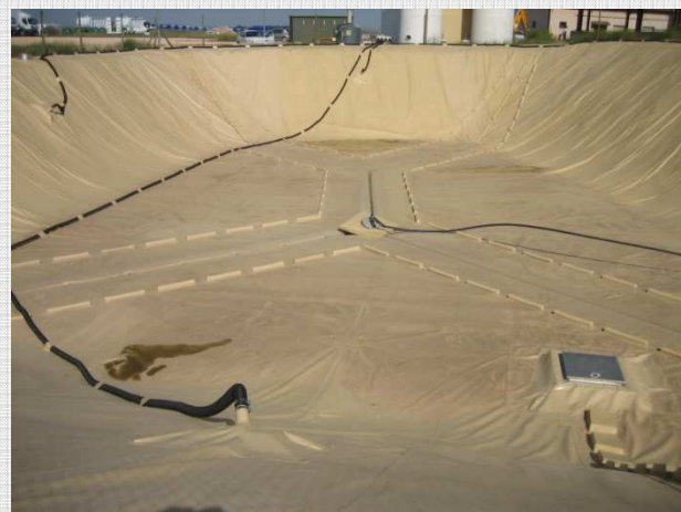
Instalación de cubierta flotante y equipo de desodorización en balsa de lixiviados en la planta de tratamiento de residuos de Torija. 2.000 m 2
