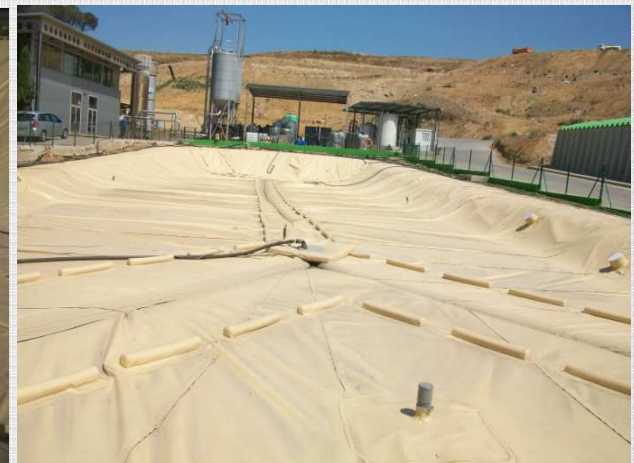
Instalación de cubierta flotante en balsa de lixiviados del vertedero de residuos industriales de Santa María de Palautordera. 1.600 m 2
