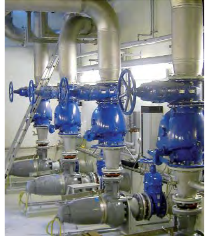
Instalación de clapeta oscilante en vertical con peso y palanca
