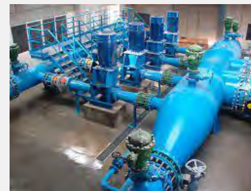
ESTACIÓN DE BOMBEO
