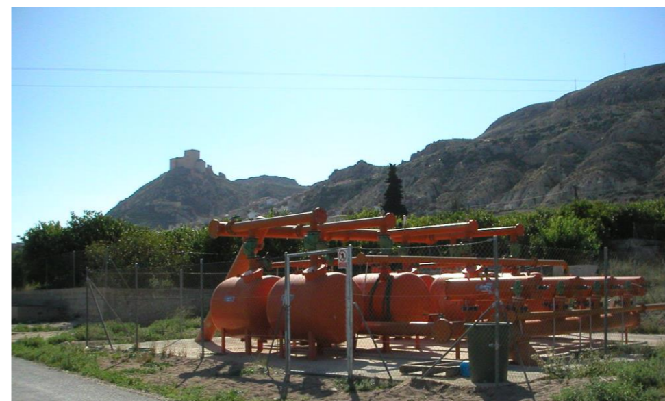
Estación de filtrado
