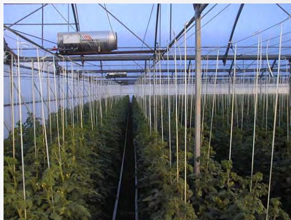
Calefacción aire caliente
