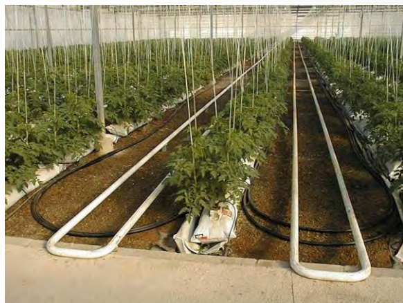
Calefacción agua caliente
